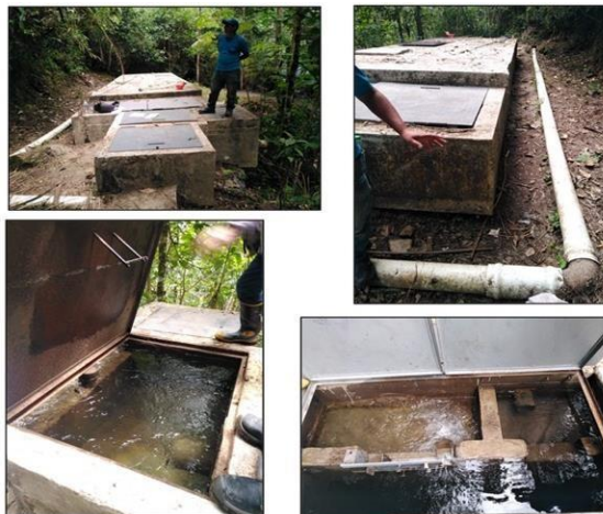
Imagen 7: Bocatoma La Arenosa. Fuente: Propia
